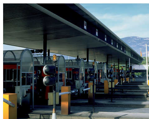
Barrière de péage Alimentation et contrôle des barrières
